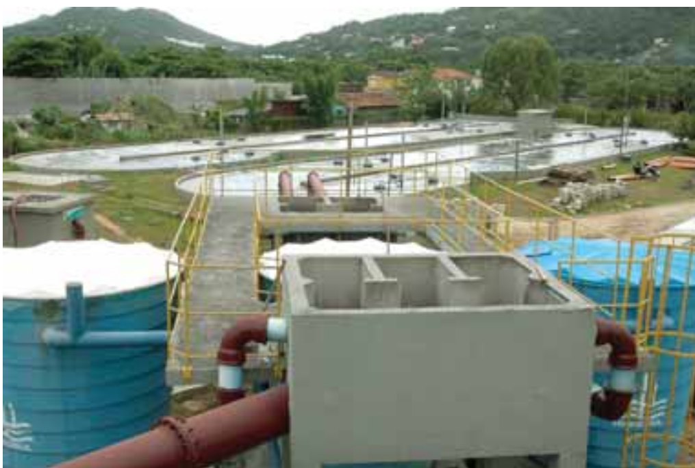
Estação de Tratamento de Esgoto da CASAN: cerca de 320 mil pessoas beneficiadas com o serviço em 2007
